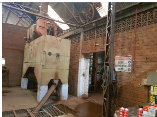
Casa de máquinas
