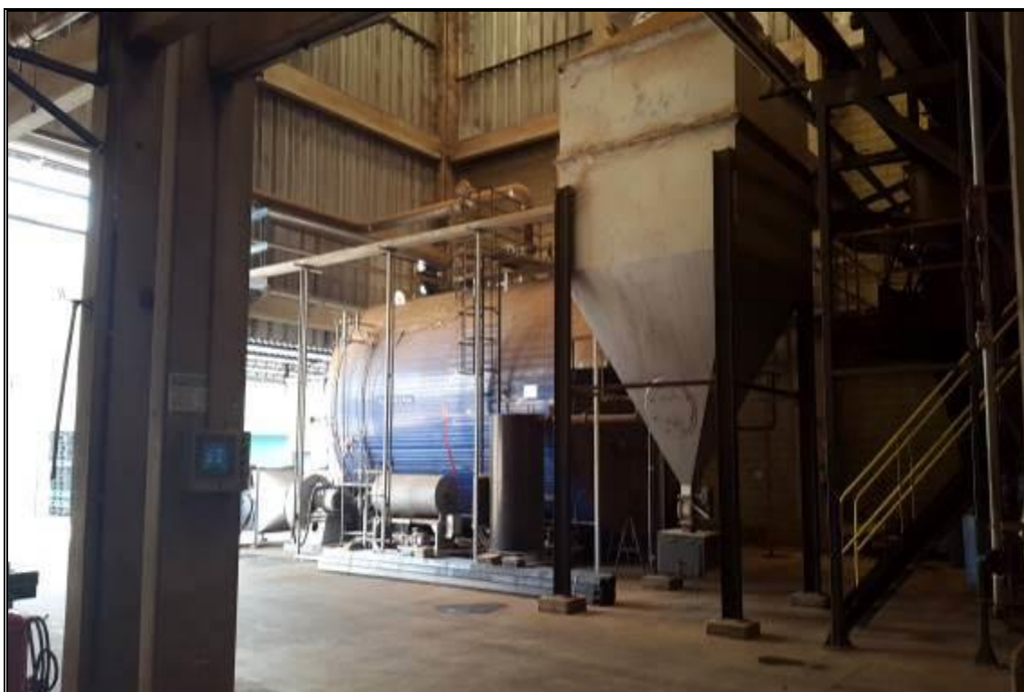
VISTA INTERNA – CALDEIRAS
