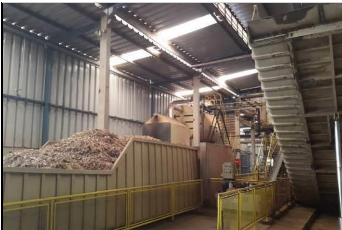
VISTA INTERNA – CALDEIRAS
