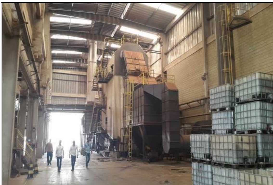
VISTA INTERNA – CALDEIRAS
