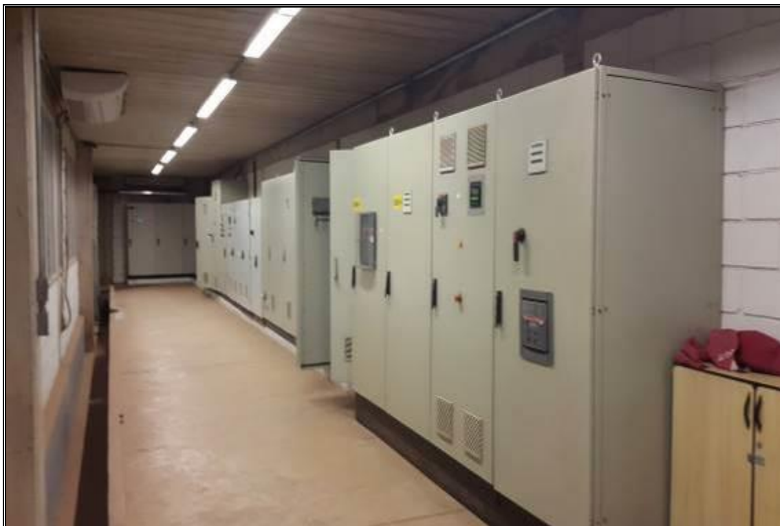
SALA DE CONTROLE - CALDEIRAS
