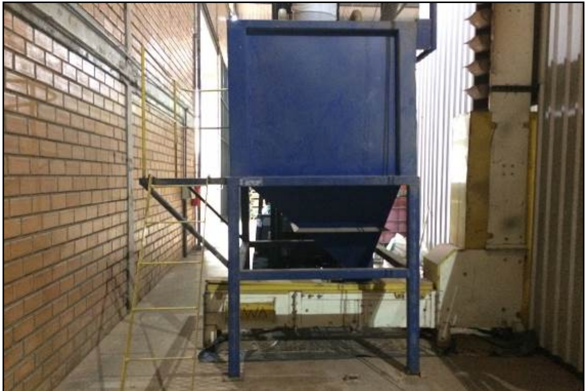
ITEM 1,001 - VISTA DO CENTRO DE TRATAMENTO DE SEMENTES MARCA: MOMENSSO MODELO: TS VHS 10T AUTO SD (MOEGA DE DESCARGA)
