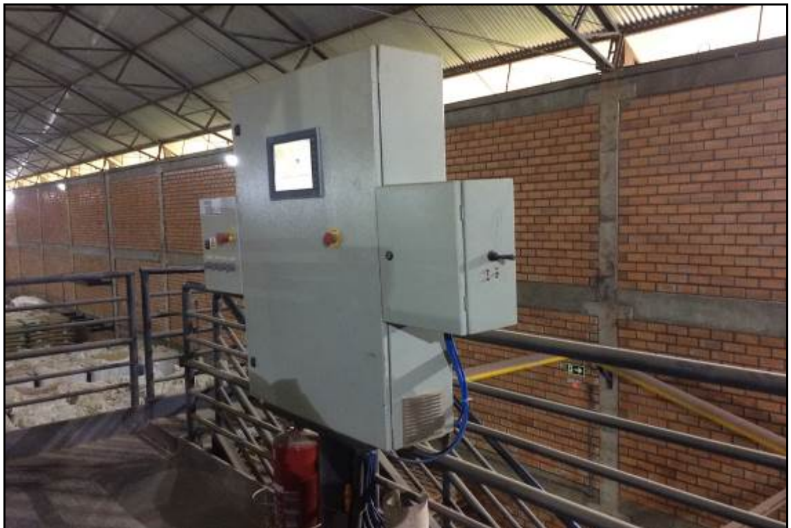
ITEM 1,001 - VISTA DO CENTRO DE TRATAMENTO DE SEMENTES MARCA: MOMENSSO MODELO: TS VHS 10T AUTO SD (PAINEL DE CONTROLE)
