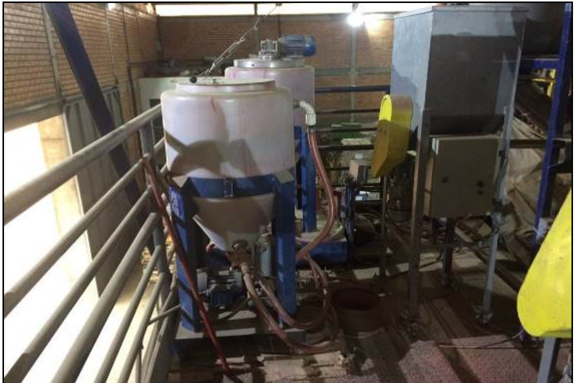
ITEM 1,001 - VISTA DO CENTRO DE TRATAMENTO DE SEMENTES MARCA: MOMENSSO MODELO: TS VHS 10T AUTO SD (TANQUE TIPO: DOS)
