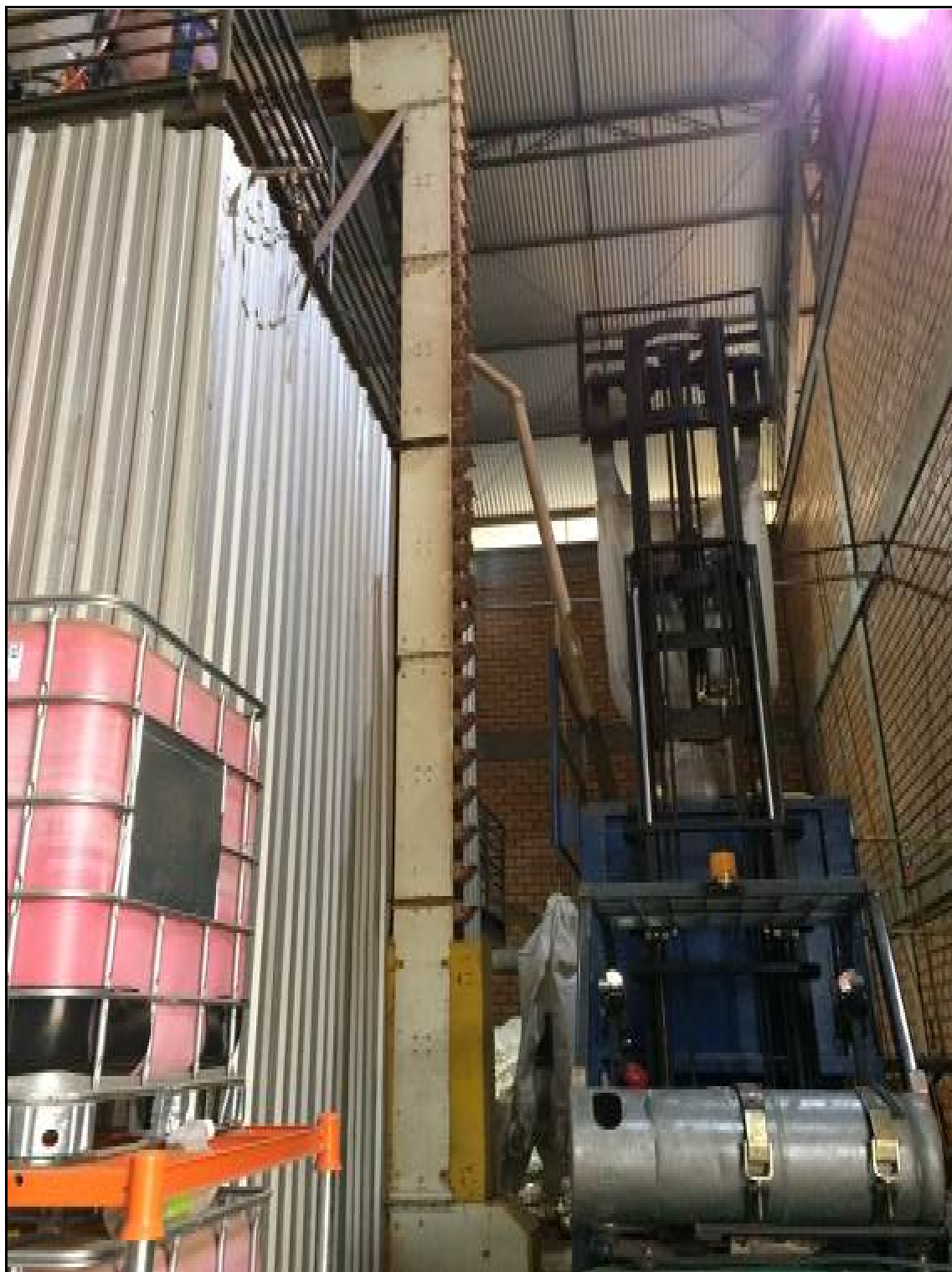
ITEM 1,001 - VISTA DO CENTRO DE TRATAMENTO DE SEMENTES MARCA: MOMENSSO MODELO: TS VHS 10T AUTO SD (ELEVADOR DE CANECA)
