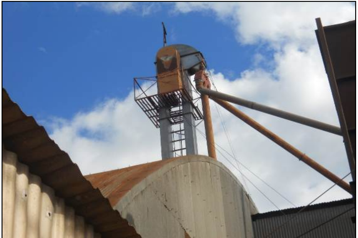
ITEM 1,008 - VISTA DO ELEVADOR DE CANECAS PLÁSTICA PARA CAPTAÇÃO DE GRÃOS DA MOEGA PARA A MÁQUINA DE PRÉ-LIMPEZA
