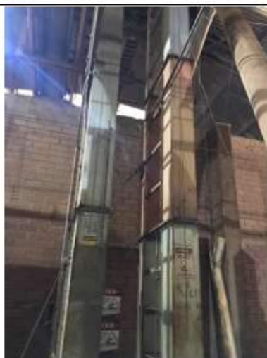
Vista Elevador de Canecas
