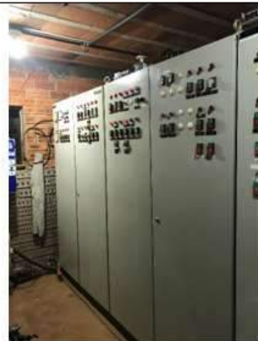
Vista Armários de Elétrica
