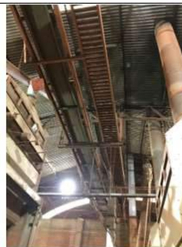
Vista da Correia Transportadora
