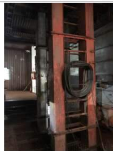
Vista Elevador de Canecas
