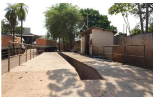
Rampa de Lavagem
