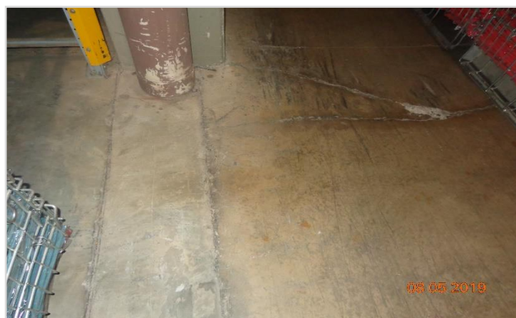
Piso Galpão - Juntas a Reparar
