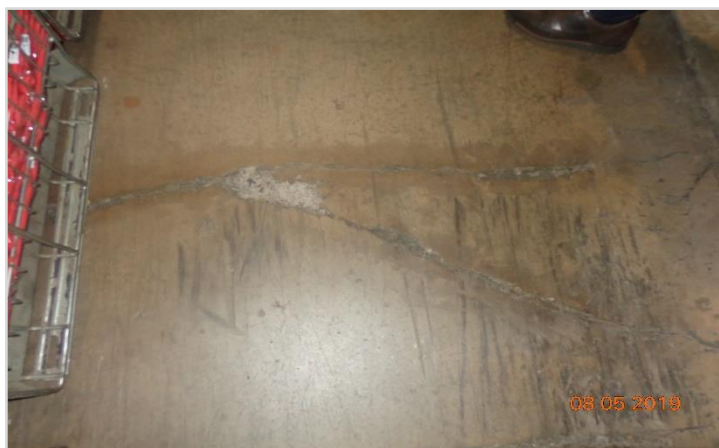
Piso Galpão - Juntas a Reparar
