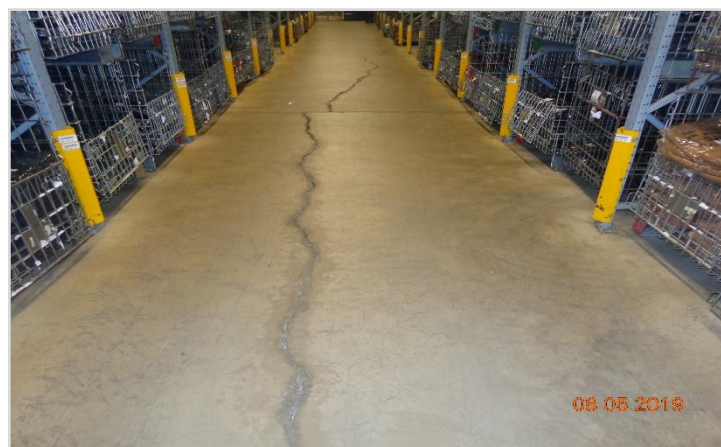
Piso Galpão – Juntas a Reparar
