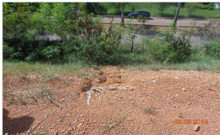
Erosão Talude Fundos
