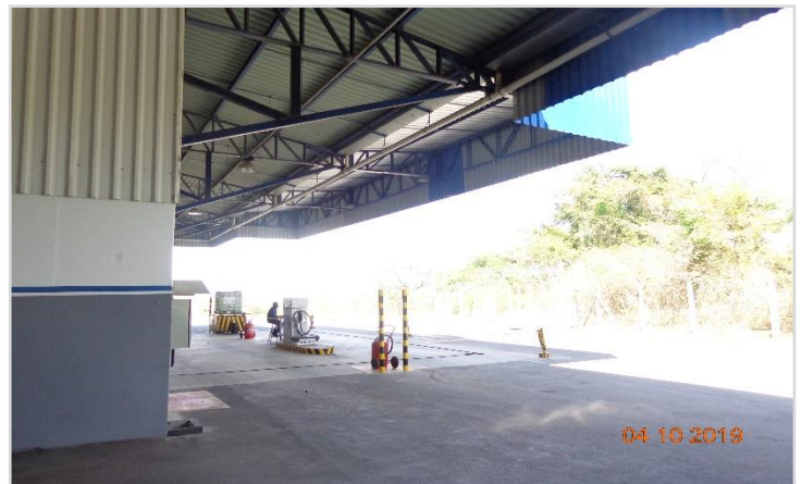
Bomba para abastecimento
