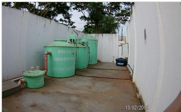
ETE -Estação de Tratamento de Esgoto
