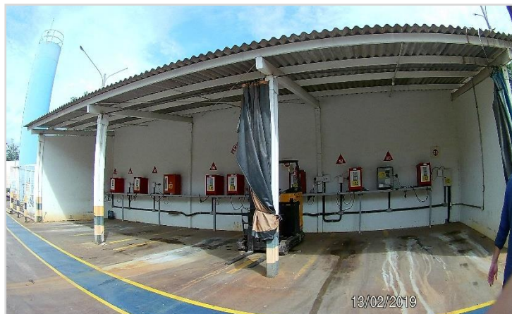
Casa de Baterias
