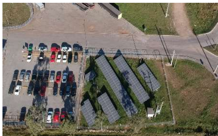
Vista Aérea Placas fotovoltaicas
