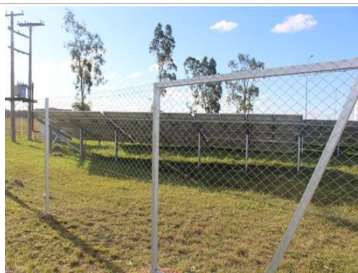
Vista Geral - Placas de energia solar
