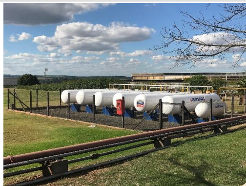
Vista Geral – Reservatórios de Gás
