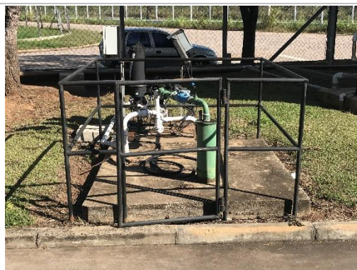
Vista Geral – Poço Artesiano
