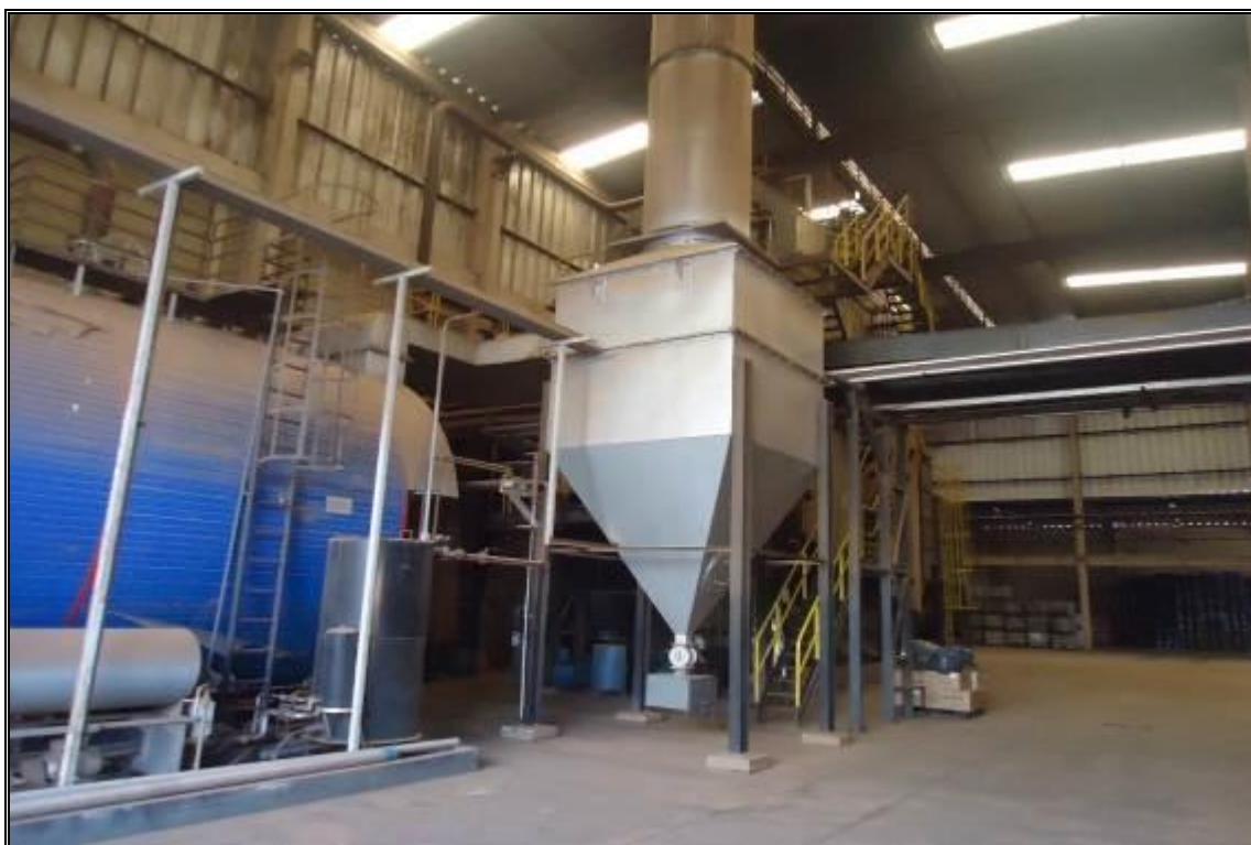
VISTA INTERNA – CALDEIRAS
