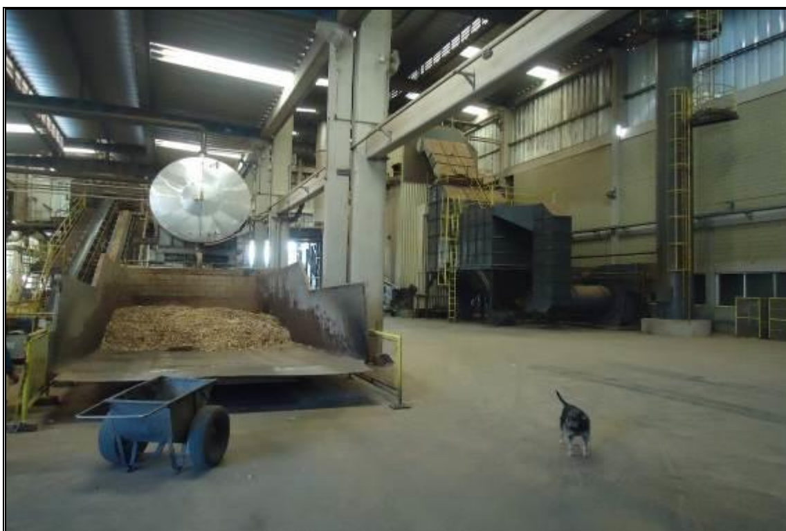
VISTA INTERNA – CALDEIRAS
