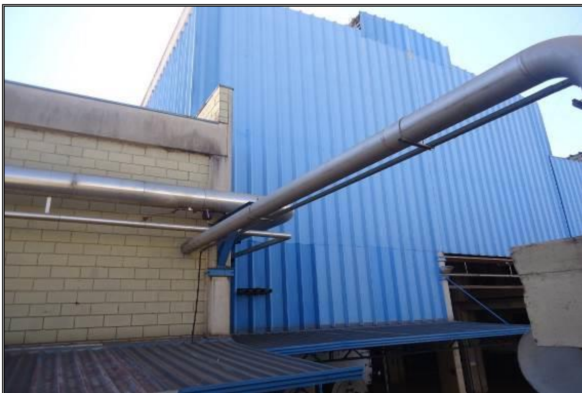
VISTA EXTERNA – CALDEIRAS
