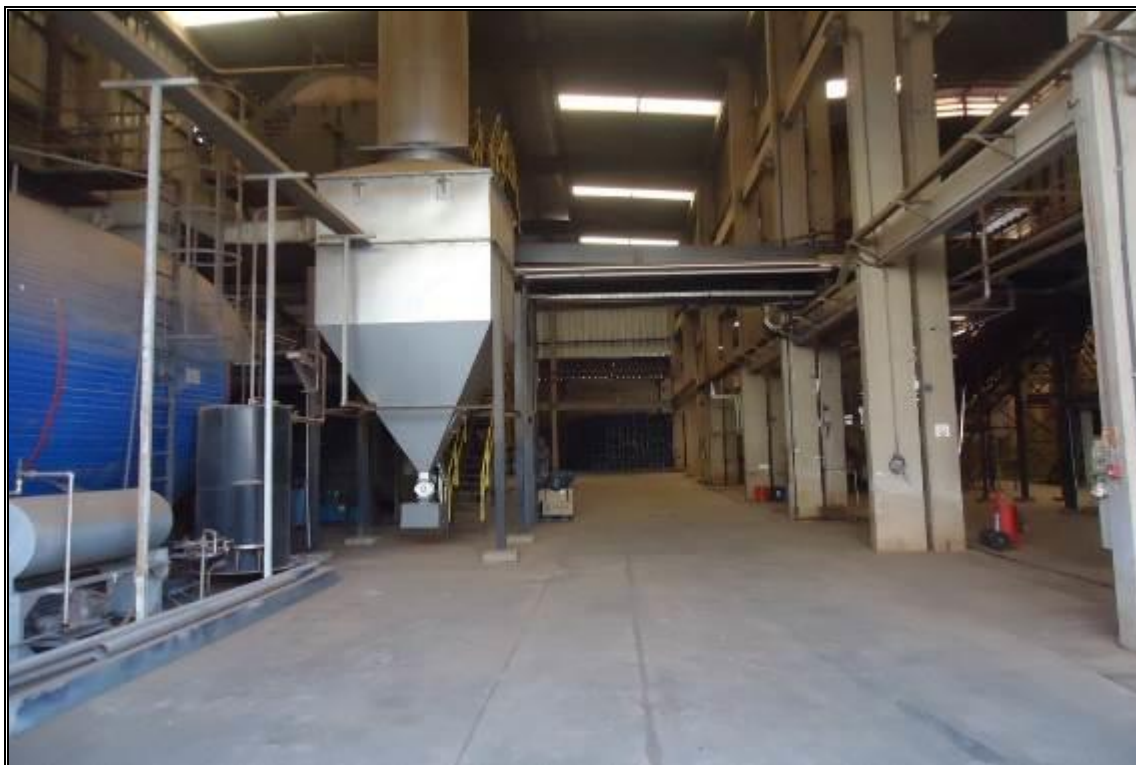
VISTA INTERNA – CALDEIRAS
