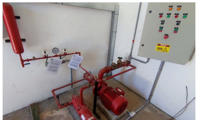
Casa de Bomba
