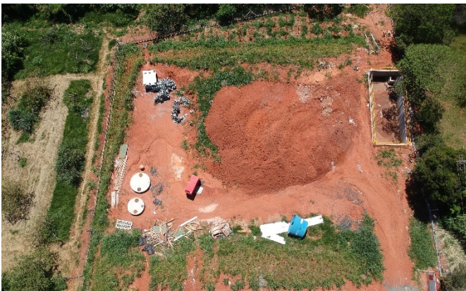
Imagem aérea – Caixa de retardo, Sistema de Fossa Séptica
