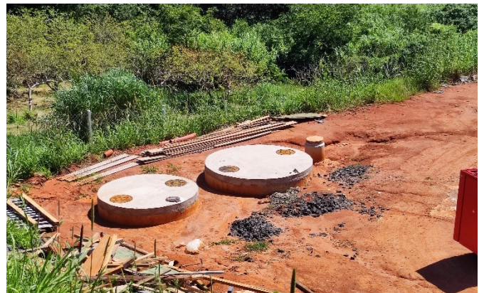
Área Externa - Sistema de Fossa Séptica
