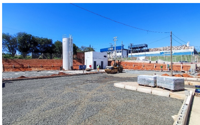
Área Externa – Reservatório e Subestação (Entrada de Energia)
